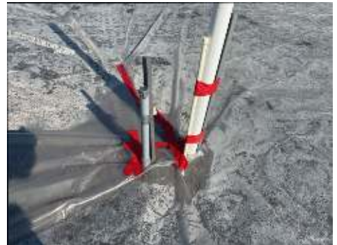
Under slab conduit
